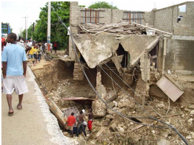
Bâtiments effondrés à CABARET
